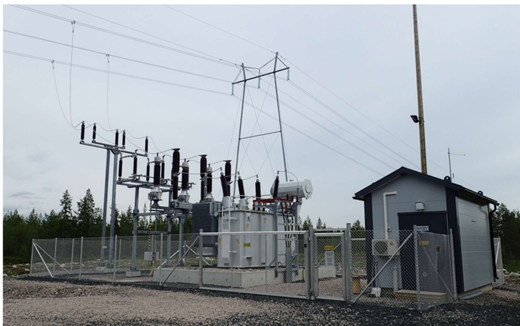
Kuva 74. Esimerkki tuulivoimapuiston sähköasemasta (kuva: FCG).
