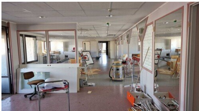
Kuva 21 Yleisnäkymää yhteistiloista. Muovimaton alla on asbestipitoinen vinyylilaatta.
