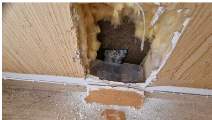
Kuva 24 Valesokkelissa ei ole vesieristettä.
